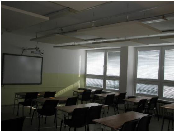
Obr. 2 - Učebňa s panelmi zavesenými pod stropom
